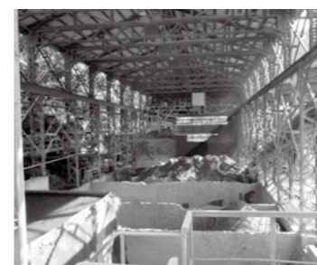
工場構内の天井クレーン建屋はUBE山陽無煙鋳業所時代のもの。頑丈な造りのため、保身をしっかりとすればまだまだ
